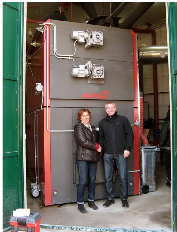
□ Kotel na biomaso Nolting LCS-RV 875/1050kW pri stranki KLIK PAR Kutina, Hrvaška
