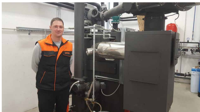
□ Kotel na biomaso Nolting LCS-RU 215/270 pri stranki IVERPAN, Zagreb, Hrvaška
