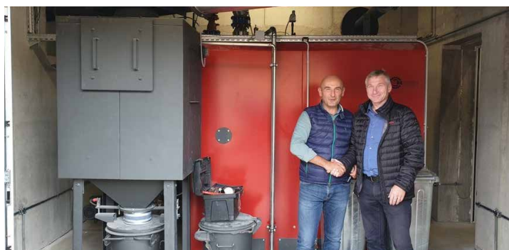
□ Kotel na biomaso Nolting LCS-RU 400/450 kW pri stranki INTERNOVA, Pazin, Hrvaška
