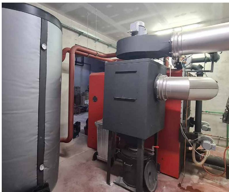
□ Kotlovnica s kotlom Nolting LCS-RU 400/450 kW pri stranki Ferotehna, Otočac, Hrvaška
