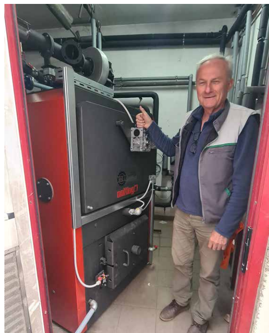
□ Kotel Nolting LCS-RU 145/205 kW pri stranki Paneli Projekt, Osijek Hrvaška
