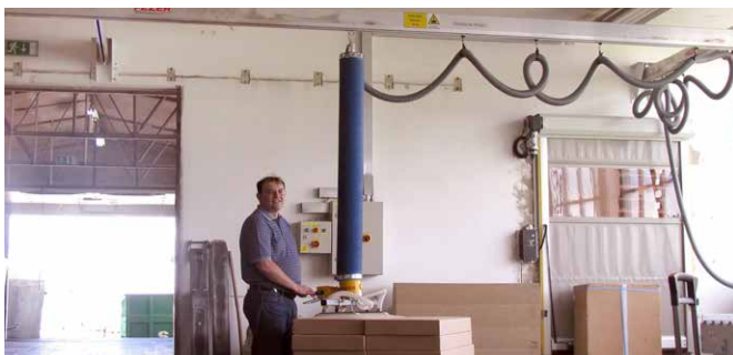
□ VacuPowerlift pri JERA-MIX-u, Begunje pri Cerknici, Slovenija
