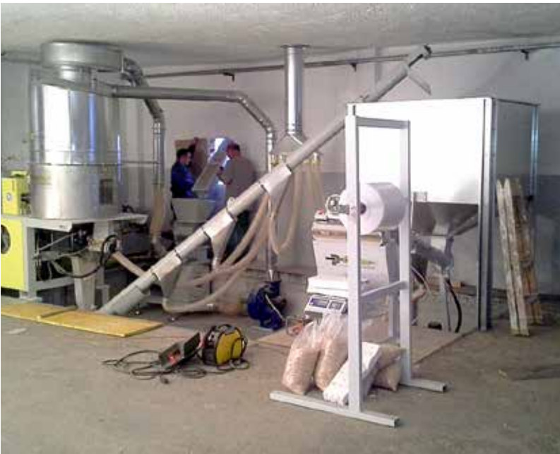
□ Linija za proizvodnju peleta P SYSTEM P 300 tijekom montaže u EXTRAFORM-u, Prestranek, Slovenija
