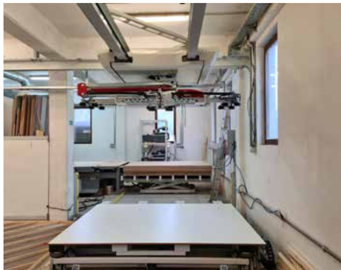
□ Automatsko skladište ploča Barbaric CSF u tvrtki MIZARSTVO ZUPANC, Selca, Slovenija
